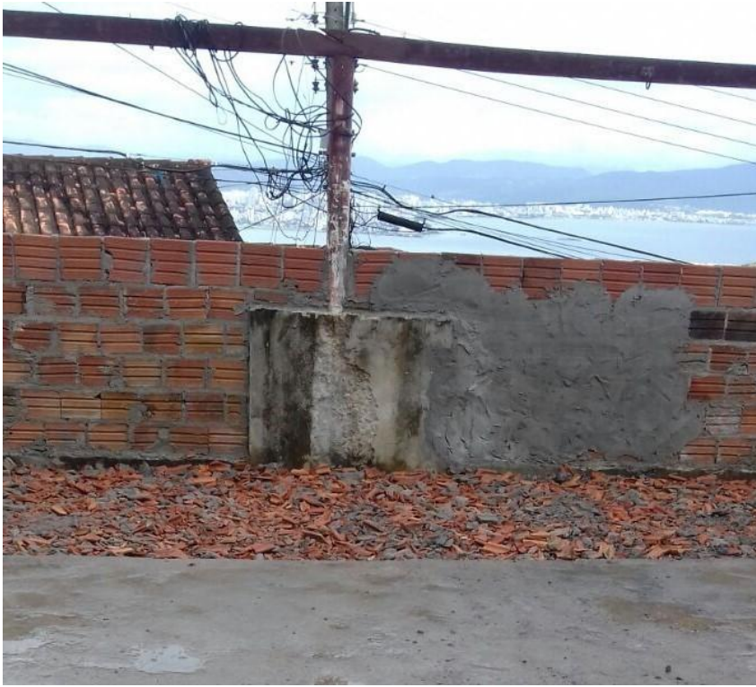
Figura 2: Fonte de alimentação de energia no início da obra, caracterizando risco aos moradores.
