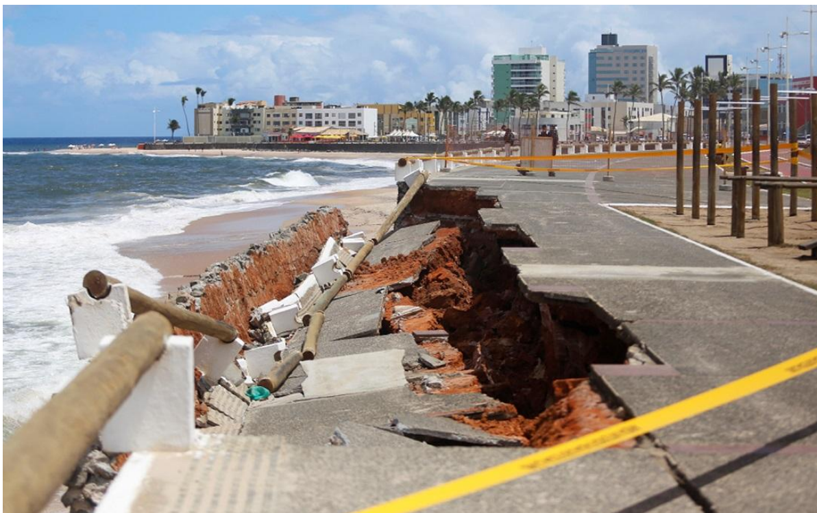
Trecho de calçada na Pituba
