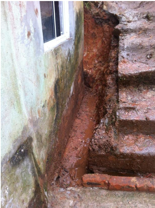
Figura 3: Situação inicial de infiltração e desvio das águas vertentes do morro.
