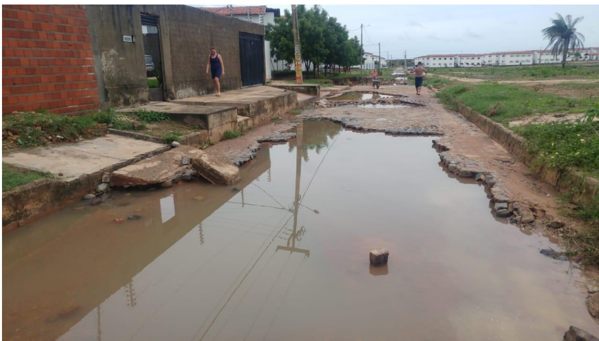
Figura 2. Ruas do Bairro Portal da Alegria após chuva.
